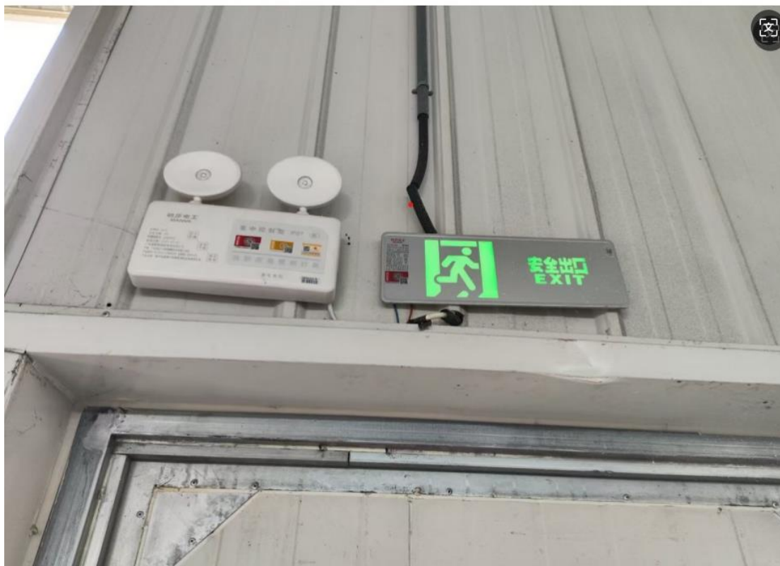
消防疏散指示及应急照明
